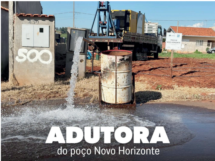
Adutora do Poço Novo Horizonte
